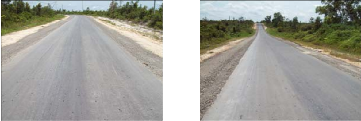
Gambar 15, Kondisi jalan asbuton campuran hangat pada jalan Pangkalan Lima – Kumai.
